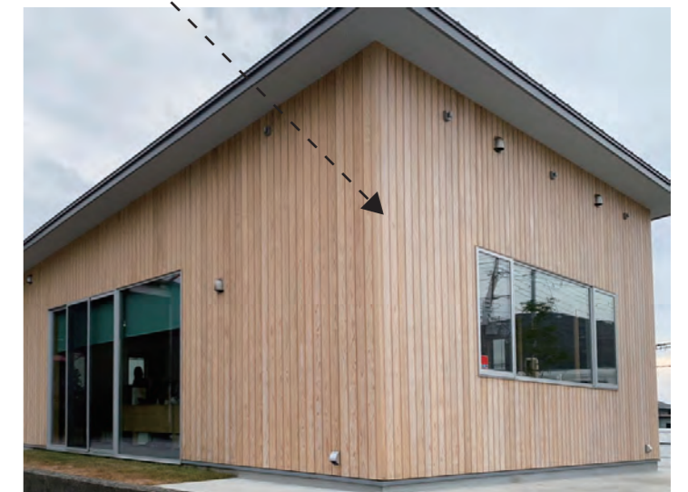
1年後のOw 国産杉 縦張り エムフェクト:クリア塗装 経年変化で色が馴染んでいきます。(源平の赤白も同様)
